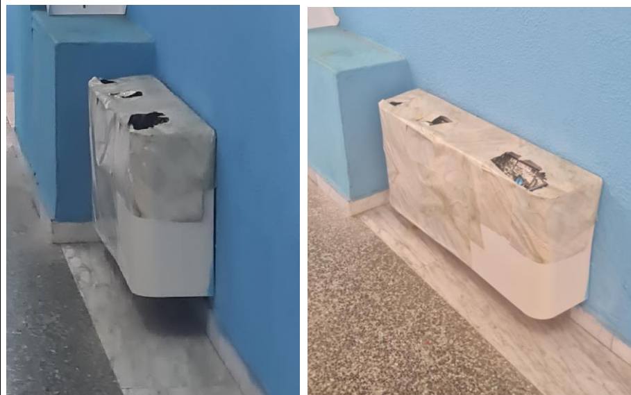
Fancoiler rotto al piano terra. Ripristinare il corretto funzionamento.
