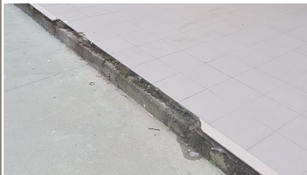
Gradini e parti della pavimentazione spaccati da ripristinare
